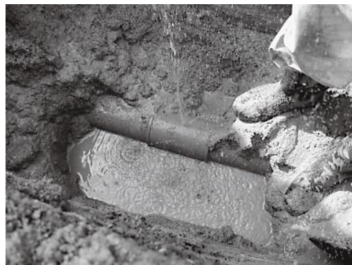
(右写真 水道管からの漏水)
