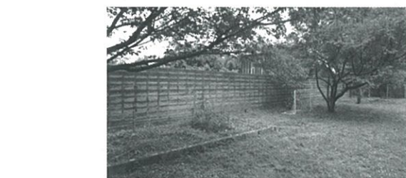
城山小学校第3運動場のブロック塀
